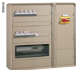
Распределительный щит с вводным выключателем-разъединителем Interpact на токи 40 – 160 A
