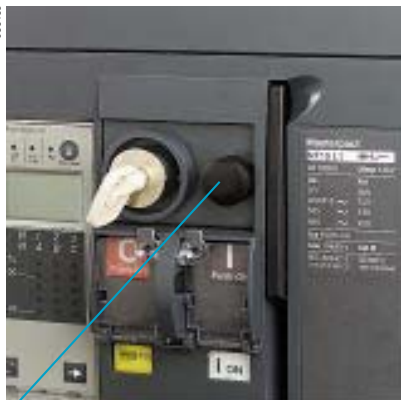
Кнопка электрического включения (BPFE)
